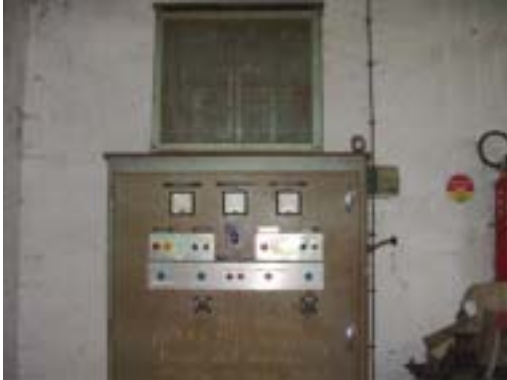
Armoire de commande St Césaire
