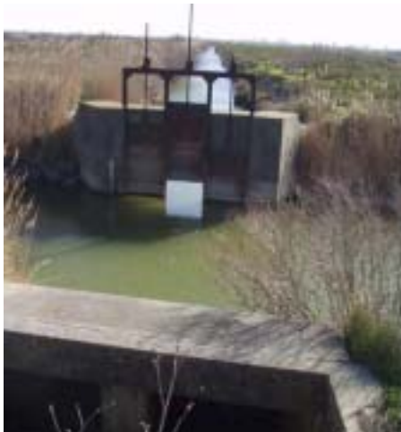
Siphon et martelière sous la Grand'Mar (interconnexion dans les 2 sens)
