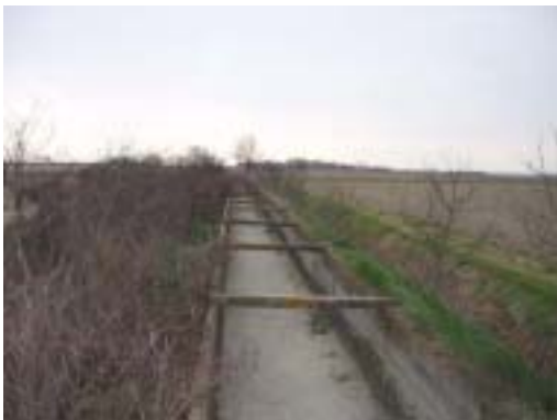
canal fragilisé entre deux roubines
