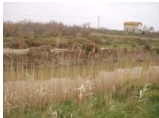
Eboulement et trous de ragondins entre l'ancienne gare et le pont
