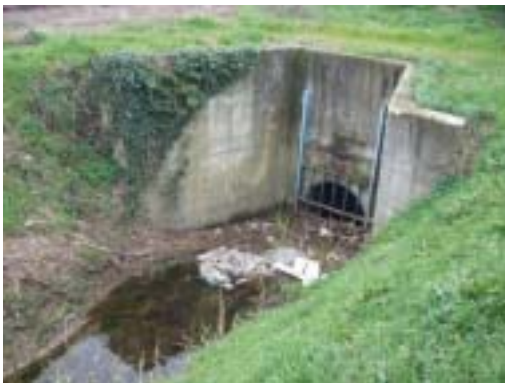
Grille avant siphon de la traversée de l'autoroute (N113)
