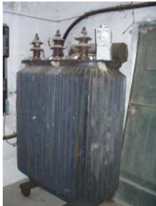
ancien transfo stocké sur le site
