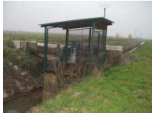
Deuxième pompe de reprise de la roubine vers le canal
