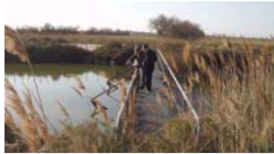
Vannes clapets de Dagon
