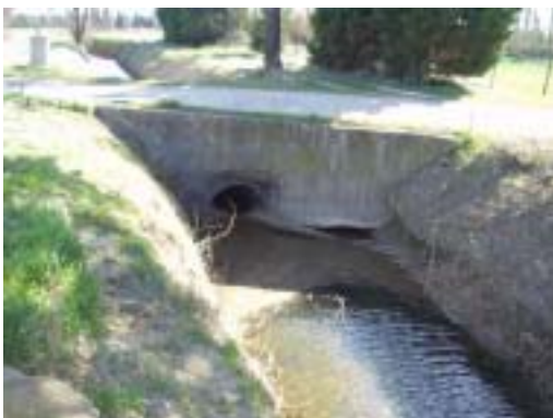
Buse et bouchon vers la Bergerie de Millet
